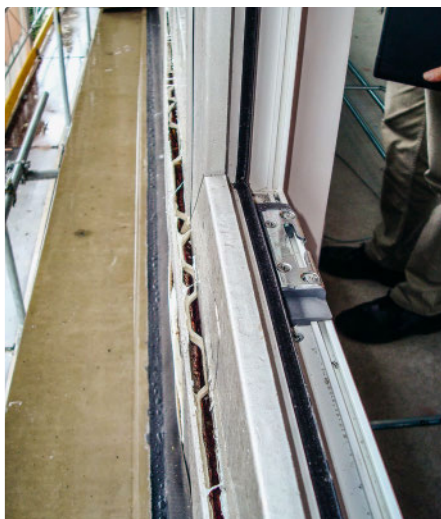
Bauschaden: irreversibel aufgequollene Rahmenverbreiterung
