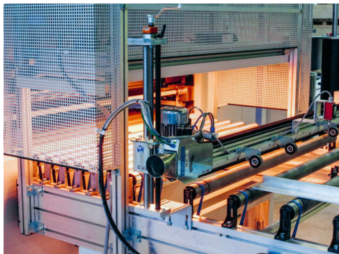
Die Tavapet-Produktionsanlage im Betrieb
