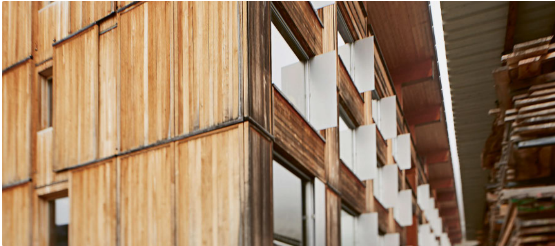
Das BFH-Lehrgebäude in Biel ist ein gutes Beispiel dafür, dass Holz das Vertrauen verdient – die Eichenfassade ist seit 20 Jahren Wind und Wetter ausgesetzt und erfüllt ihre Funktion – heute und in Zukunft.
