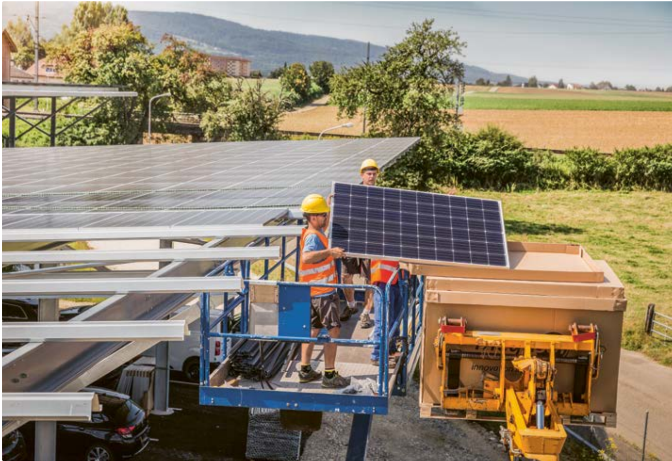
Sonnenkraftwerk, Courgenay (Quelle: BKW)
